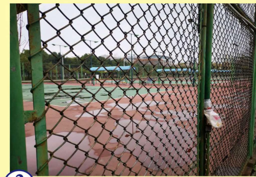
图2 西南XX大学网球场勾花网变形损坏情况
