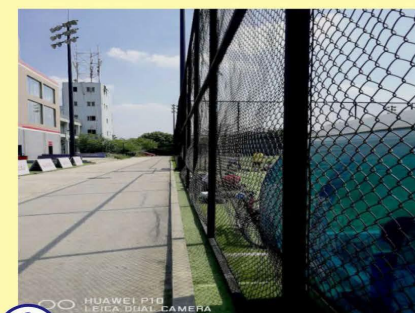
图3 成都双流机场东侧空港足球公园新建不到半年勾花围栏就出现全场严重变形
