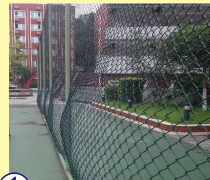
图1 四川简阳通材中学篮球场新建一年后的勾花网变形情况
