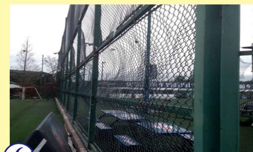
图6 成都市城南足球公园勾花围栏被足球冲撞惨遭损坏与变形的情况
