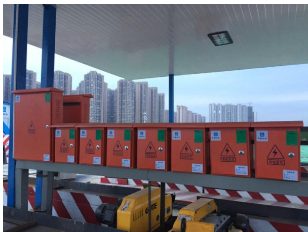
钢筋加工棚配电箱
